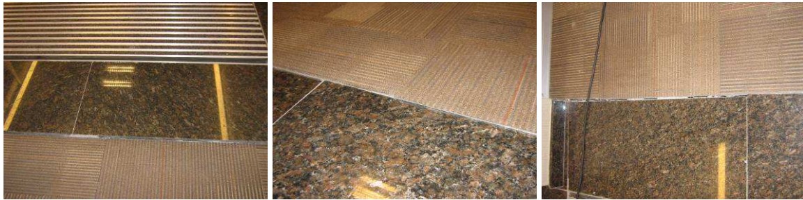
Diferencias de nivel entre solado de Palier de Ascensores y alfombra sobre piso técnico.
