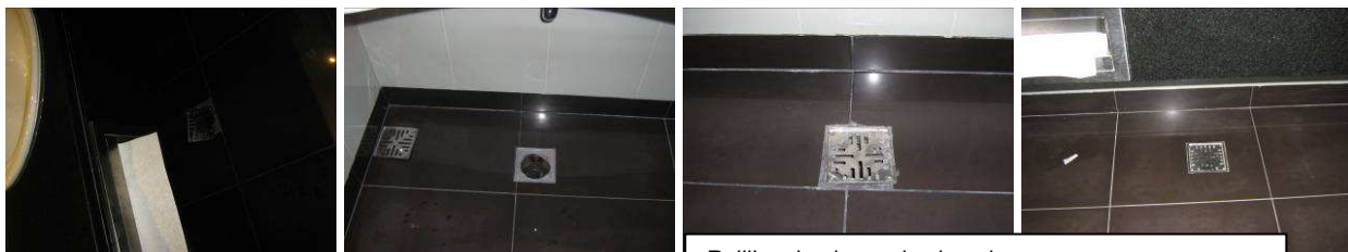
Rejillas de piso mal colocadas. Ejemplos piso tercero, decimo, décimosegundo y catorce. TAREAS EN EJECUCION
