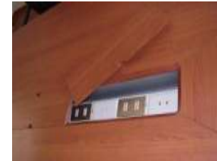
CAJA DE ELECTRIFICACION
