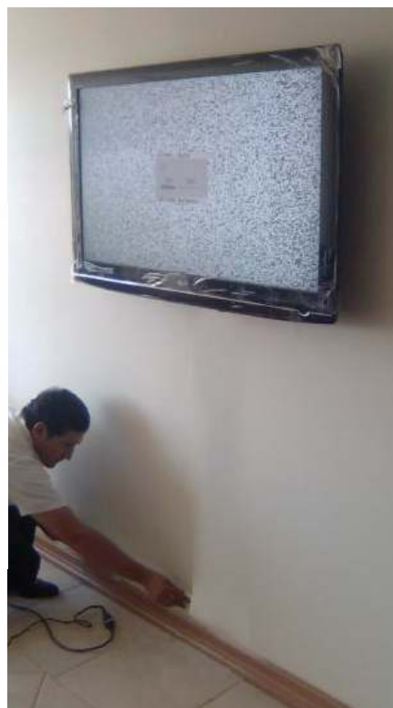
LCD 40" Incluye soporte a muro, refuerzo y canalización
