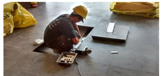
Piso 3- Canalizaciones para cableado bajo piso tecnico. (Dalux)
