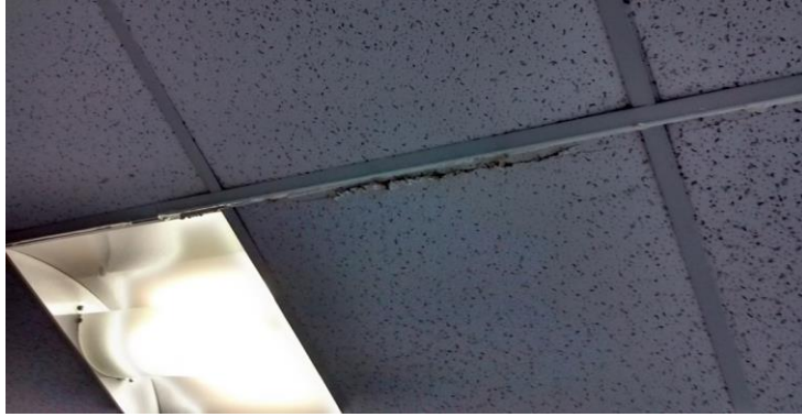
Cielorrasos desmontable con placas dañada
