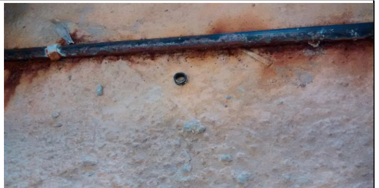
Se observan algunas cañeras rígidas con estado de corrosión
