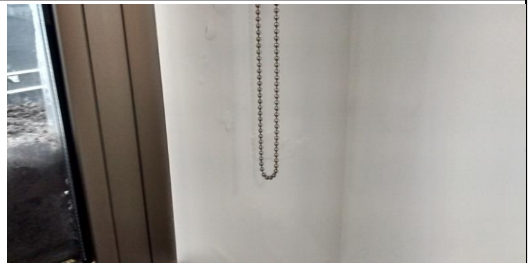
Humedad en muros laterales a carpinterías y desprendimientos de revoque
