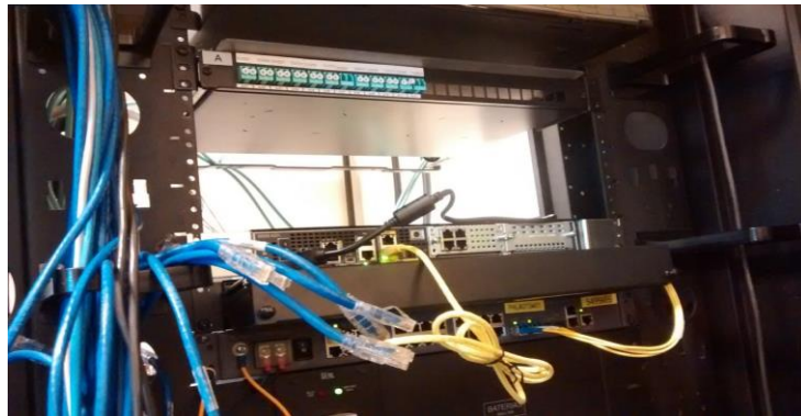
Bandeja con frente calado de FO, Switch, UPS (a verificar estado)
