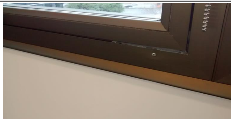
Se encuentran vetanas perimetrales selladas y atornilladas sin posibilidad de aperutara
