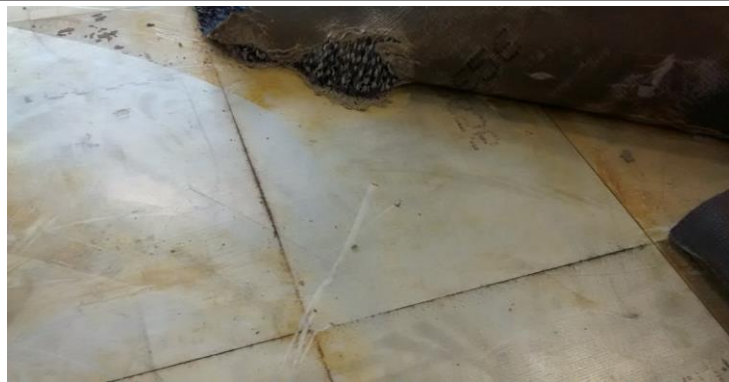
Alfombras adheridas a piso tecnico con cemento de contacto
