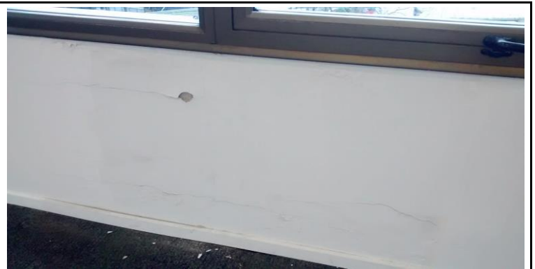
Se observa en antepechos signos de humedad y desprendimientos de revoques y zocalos
