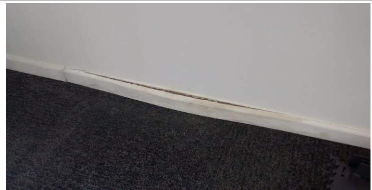
Desprendimiento de zocalos en sectores varios por humedad
