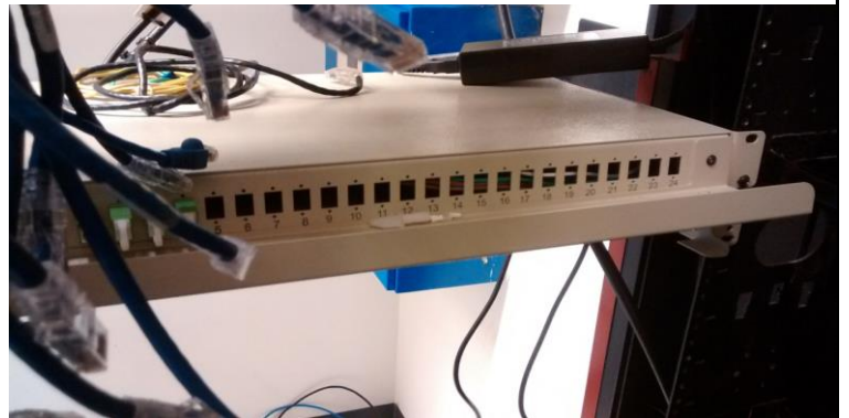
Bandeja con frente calado para Fibra optica (A verificar estado)
