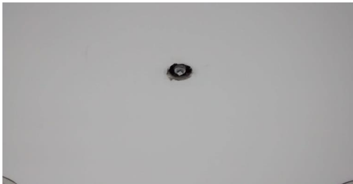
Faltante de roseta de sprinkler
