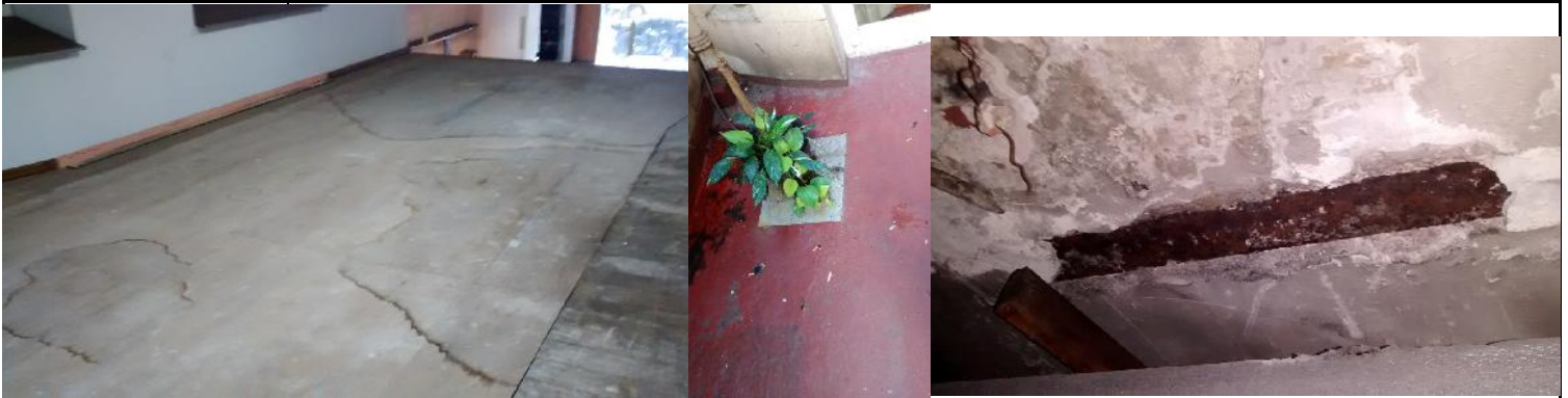
Señales de filtraciones de agua anteriores
