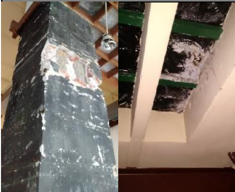
Actual filtracion de agua en cubierta de patio superior.
