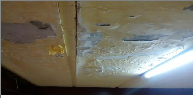
Deterioro de cielorraso por filtraciones anteriores.
