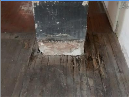
Piso de madera deteriorado por filtraciones de agua anteriores
