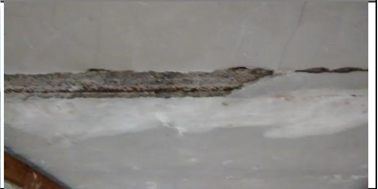
Viguetas de bovedilla corroidas por humedad contenida, desprendimiento de revoque por expansion de corrosion.
