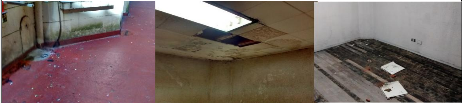
Reparaciones precarias en aislacion de patio sobre cubierta.
