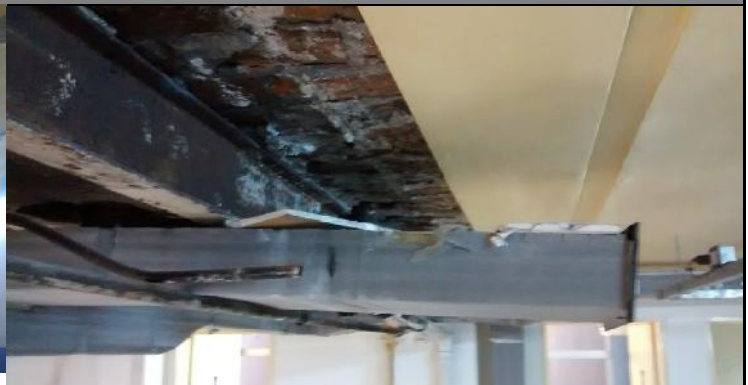
Vigas oxidadas por humedades de filtracion anteriores.
