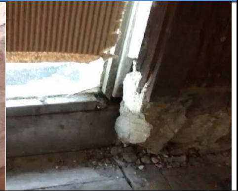
Vidrio de frente rajado en esquina. Senales de anteriores filtraciones de agua.
