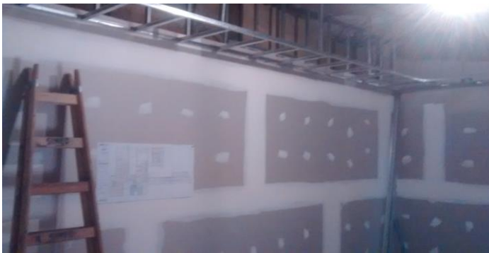
Estructura de ajuste perimetral de cielorraso. Sala de reunion principal.
