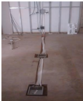
Canalizaciones de energia y comunicaciones para mesas de reunion.
