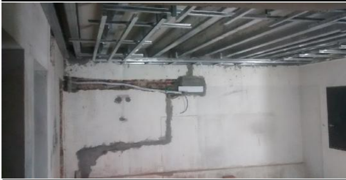
Estructura para ajustes de cielorraso sobre Sala de reunion PB. unidad Split.
