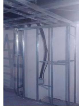
Cajas de acceso y canalizaciones electricas en para Puestos de trabajo. PB.
