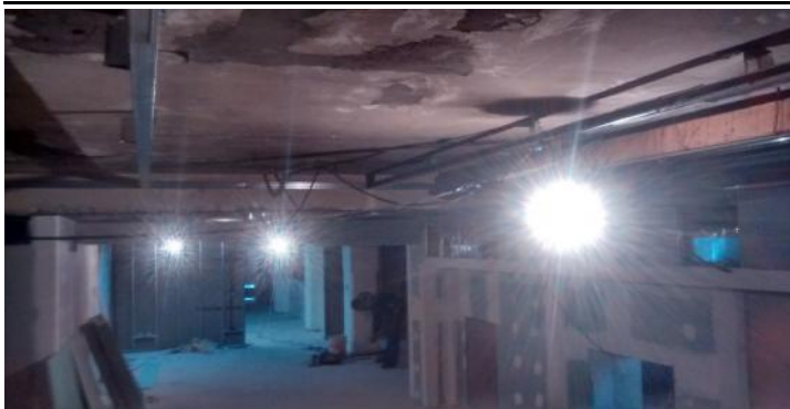
Canalizaciones para iluminacion en Depositos. EP.
