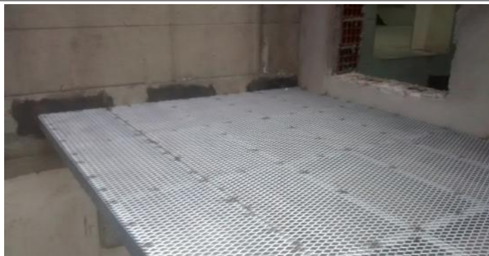
Piso metalico sobre plataforma exterior para unidades Condensadoras de Aire Acondicionado.
