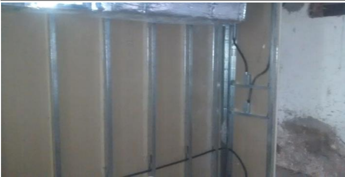
Canalizaciones y cajas para Servicios y Termostatos en divisiones de Planta Baja.
