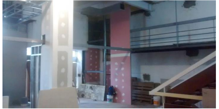
Revestimiento Ignifugo de Caja de Montacargas.
