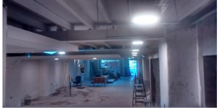
Iluminación de circulaciones.
