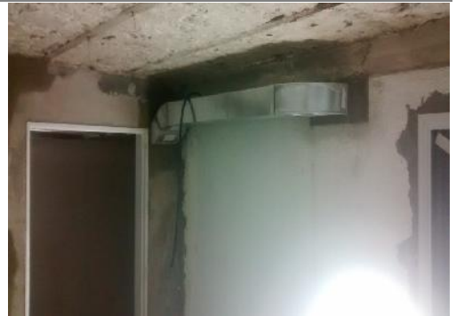
Conductos para toma de aire exterior.
