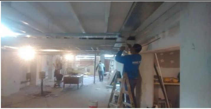
Refuerzos estructurales para soporte de guías d Montacargas.
