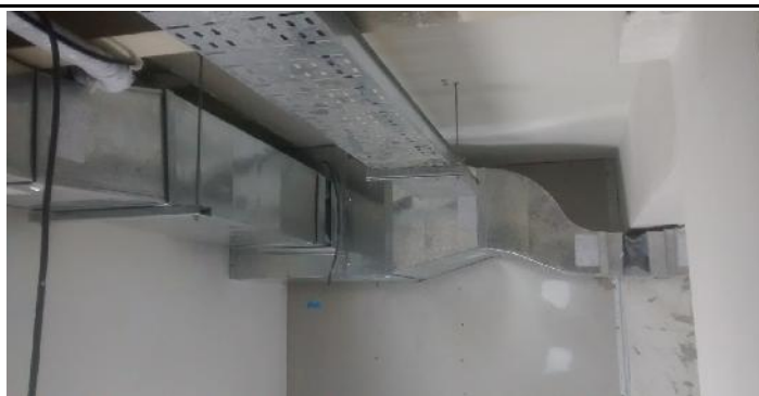
Conductos y ventilador para sistema de extraccion. Depositos de Planta Alta.
