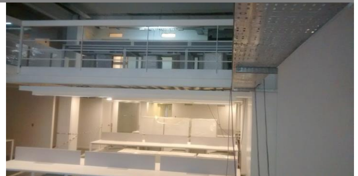
Bandejas para cableado de energia y comunicaciones.
