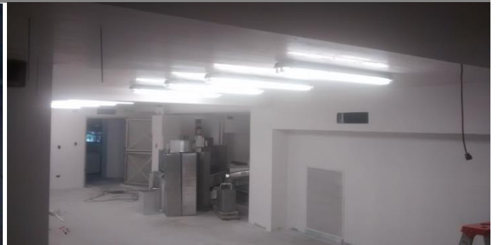
Iluminacion de artefactos estancos en Deposito.
