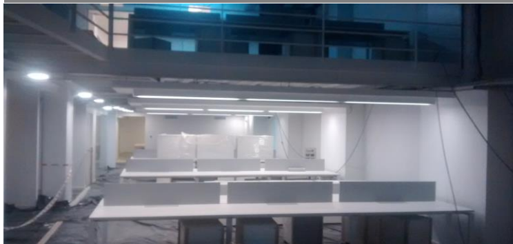
Iluminacion sobre puestos de trabajo y circulacion. Planta Baja.
