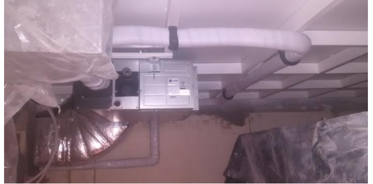
Instalacion de Aire Acondicionado. Unidad evaporadora para oficina de presidencia.
