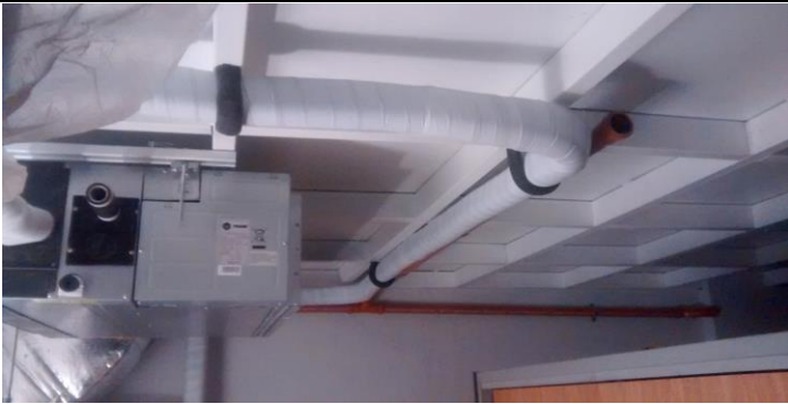
Tuberías de cobre aisladas y desagües de condensado. Unidad de AA para oficina de presidencia.
