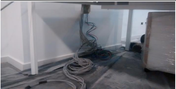
Acometida a bandeja pasa cable. Islas de puestos operativos.
