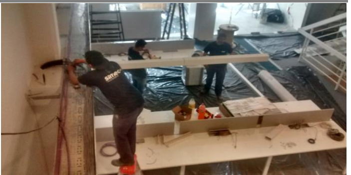
Cableado de energía y datos en puestos de trabajo.
