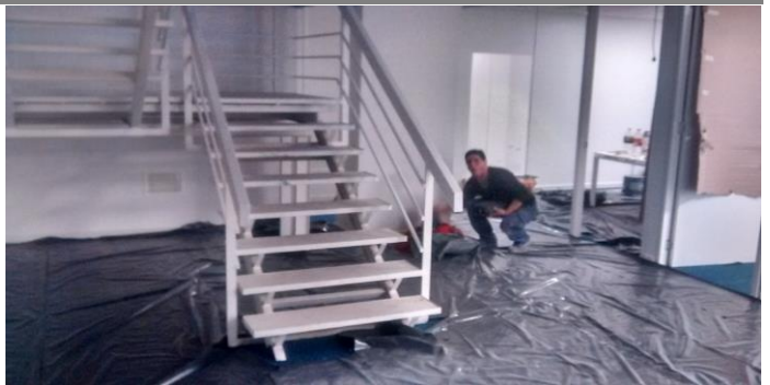
Alfombrado y protección. Foyer de Salas de reunión. Subsuelo.
