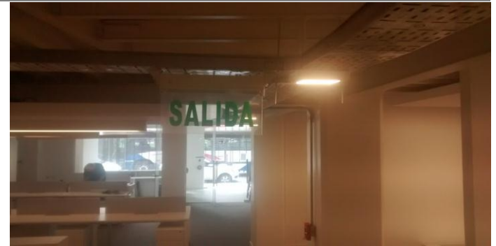
Cartelería de evacuación.
