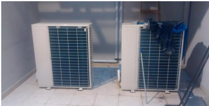
Conexión de unidades exteriores en patio.
