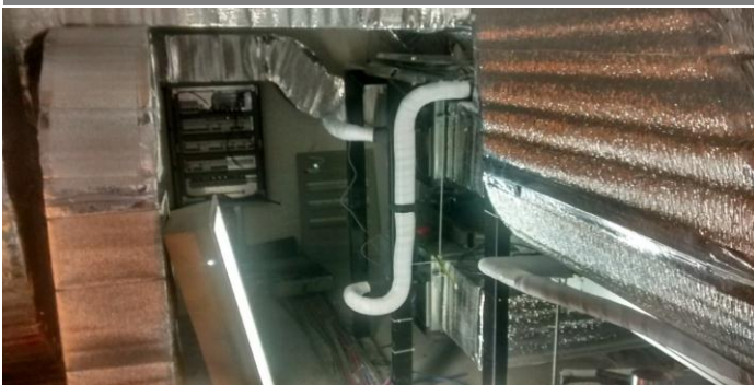
Conductos en Sala de maquinas AA..
