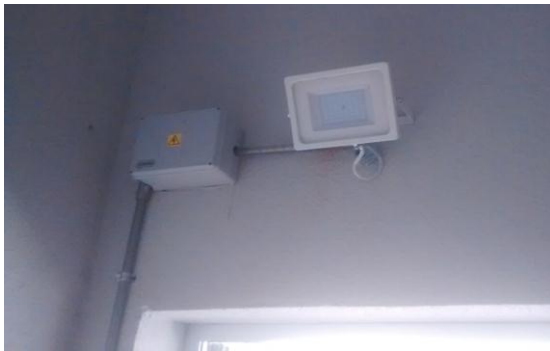
Caja de acceso para servicios externos. Instalación de reflectores en patios.
