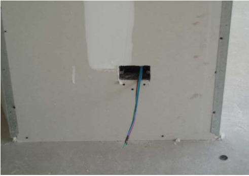
CABLEADO CIRCUITOS TOMAS USO GENERAL PISO 8.
