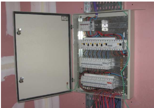
ARMADO DE TABLERO PRINCIPAL EN DATA CENTER
