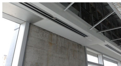
Filtracion en cubierta.
