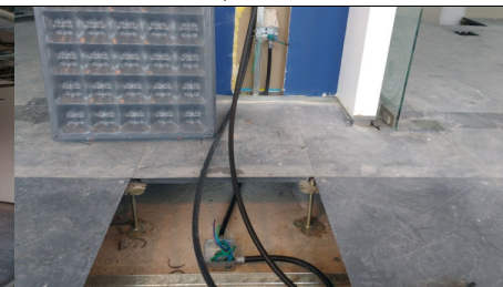
Cableado completo circ. Tomas
