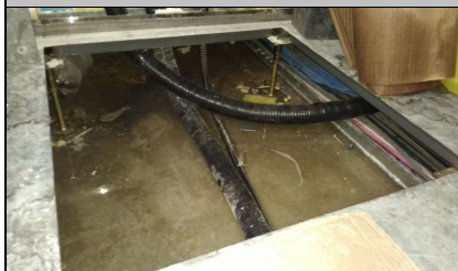
Agua bajo piso técnico: motivo de demoras
