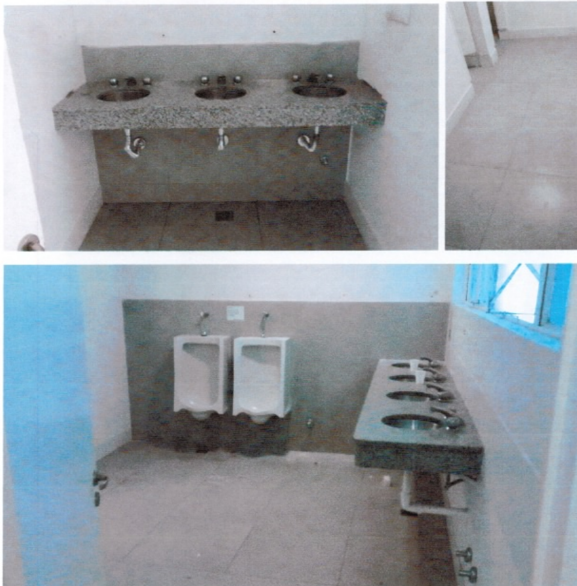
FOTO 12/13/14: Estado de los sanitarios existentes de PB
