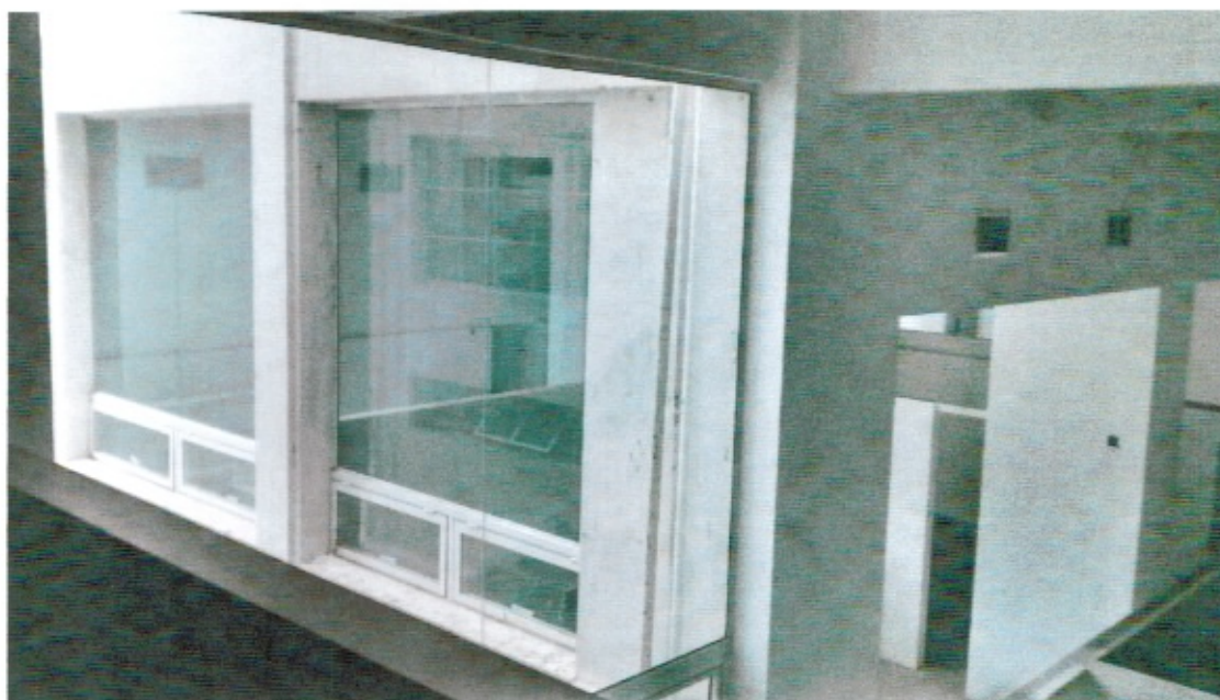
FOTO 8/9: Se observa el ventanal con fisuras en el dinatel superior
