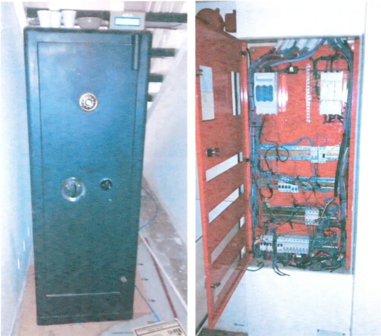
FOTO 10/11: Se observa el estado de los tableros a la fecha de toma de posesión.
