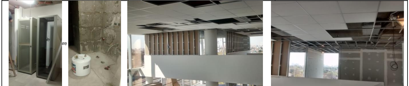
Server y baño privado
