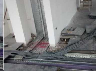
Bandejas y cableado
