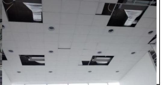
Cielorraso y difusores
