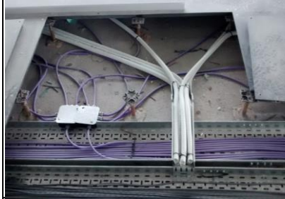
Bandejas y cableado
