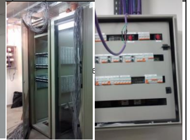
Server y tableros
