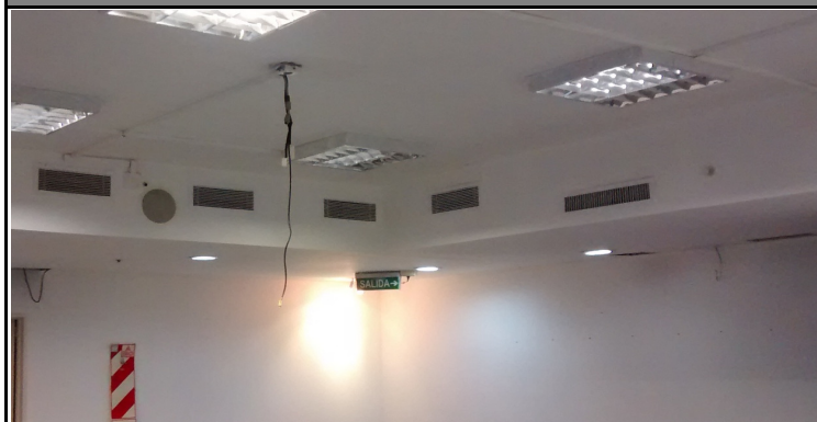
Cartel de emergencia no funciona.
